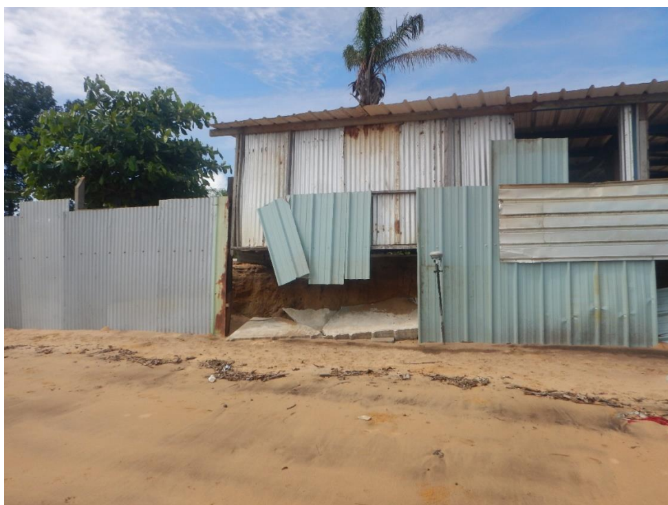
Figure 57 : Photographie d'une des habitations dans la zone en érosion (Figure 56b).
