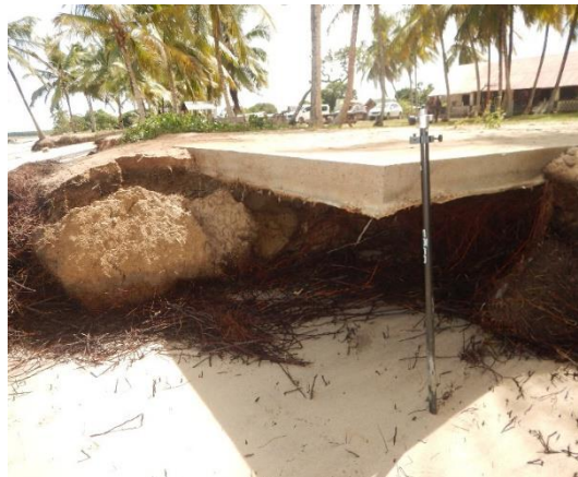
Figure 63 : Érosion sous une dalle de béton d'environ 90 cm novembre 2020.
