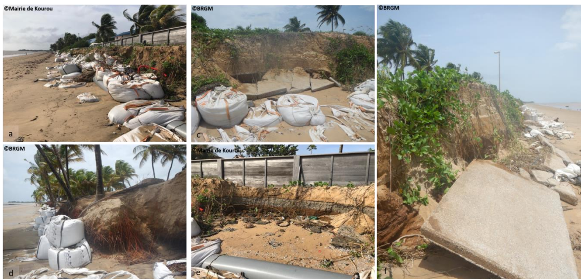
Figure 53 : Dégâts observés suite aux coups de mer d'avril 2020 le long de l'avenue de l'Anse (prise le 11 avril 2020) (Bossennec et Longueville, 2020).
