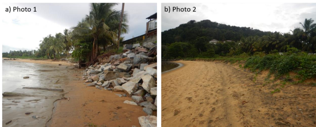
Figure 31 : (a) extrémité Nord : entretien des enrochements (b) extrémité Sud : talus d'érosion (photos novembre 2020).
