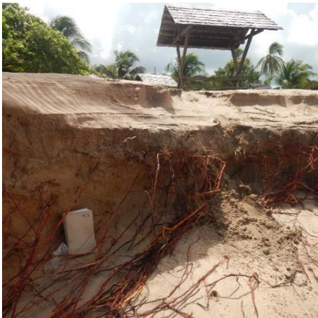
Figure 64 : Talus d'érosion de 70 cm, novembre 2020.
